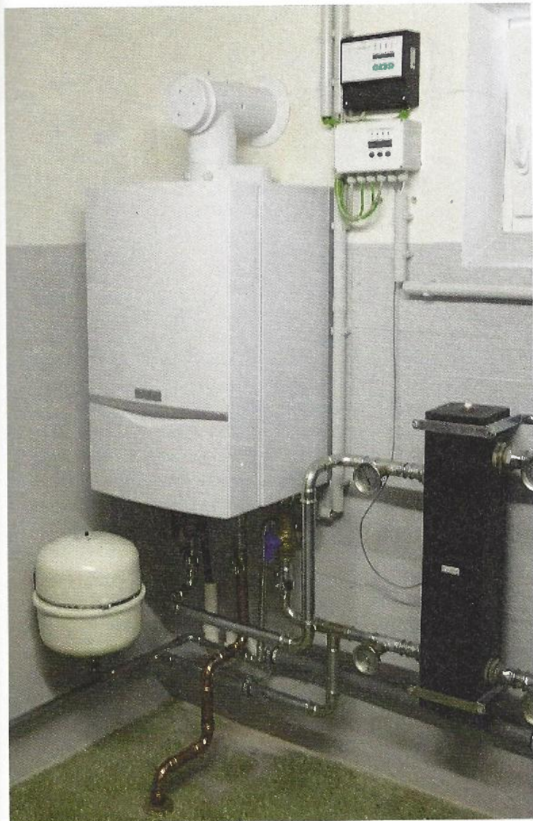
Eine einzige Brennwerttherme versorgt 18 Wohnungen mit Wärme und Warmwasser
