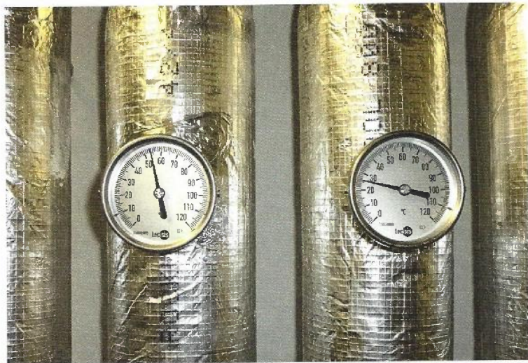
Vorlauftemperatur 55 Grad, Rücklauftemperatur 25 Grad, dadurch volle Brennwertnutzung.
